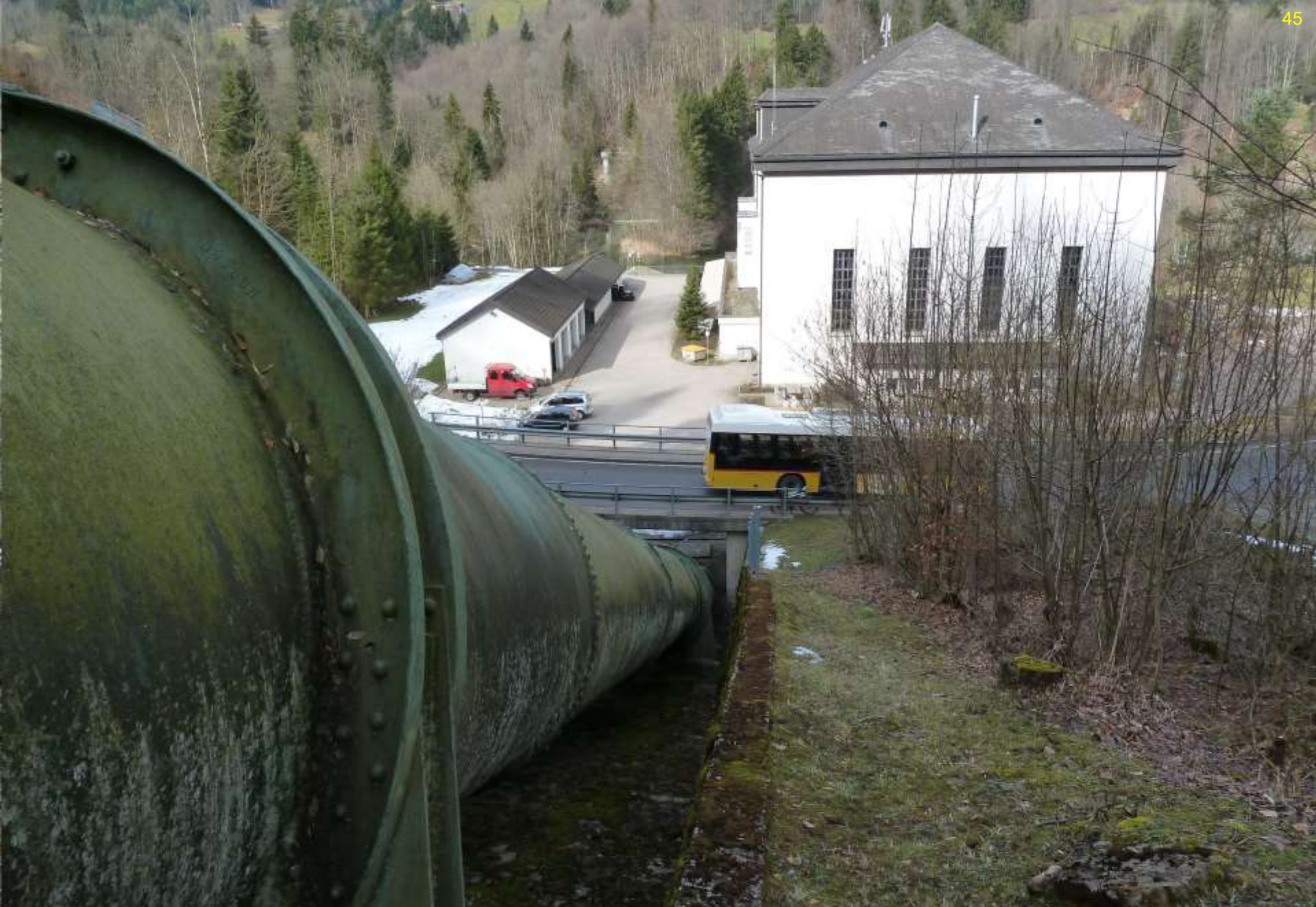
Druckleitung der Zentrale Rempfen mit Postauto, 25.02.14
